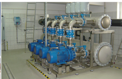
PWiK w Malborku – pompownia
