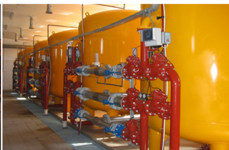
Stacja Uzdatniania Wody w Walendowie – stacja filtrów
