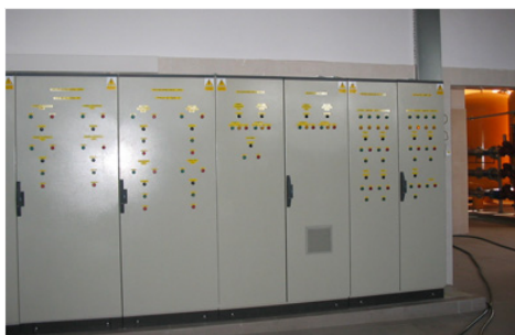
Stacja Uzdatniania Wody w Walendowie – rozdzielnia
